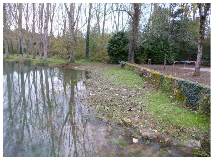
Photo 6 :Création de banquette végétalisée sur la Dive de Couhé à Châtillon (NCA 2013)
