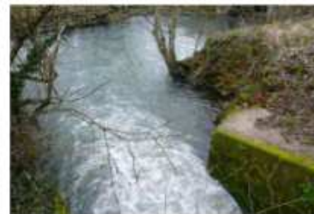
Erosion au niveau de la vanne B
